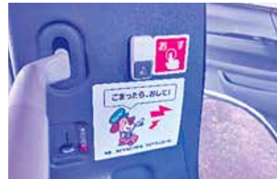
取り付けられた警報ブザー
