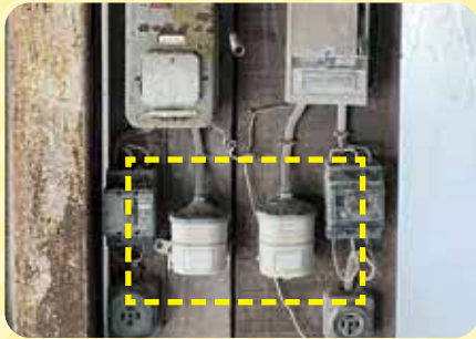
古い工場や廃ホテルの配電盤や動力盤などから
